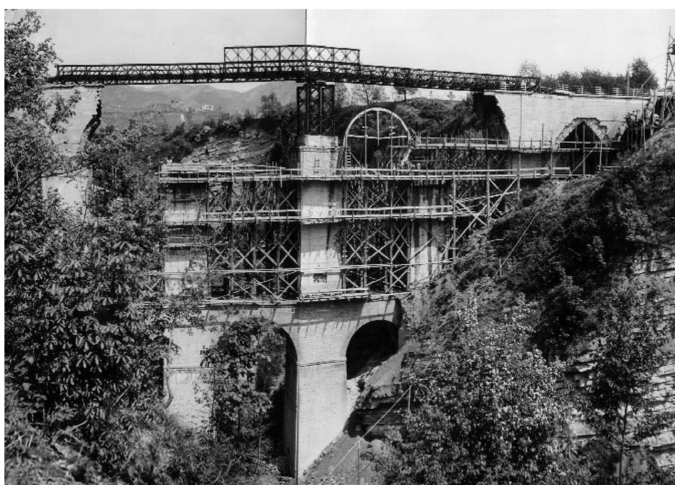
Lavori di ricostruzione delle arcate del ponte di Gaggio, distrutte durante l'ultimo conflitto bellico. Un ponte Bailey collega ancora le due estremità del ponte (ASPB)
