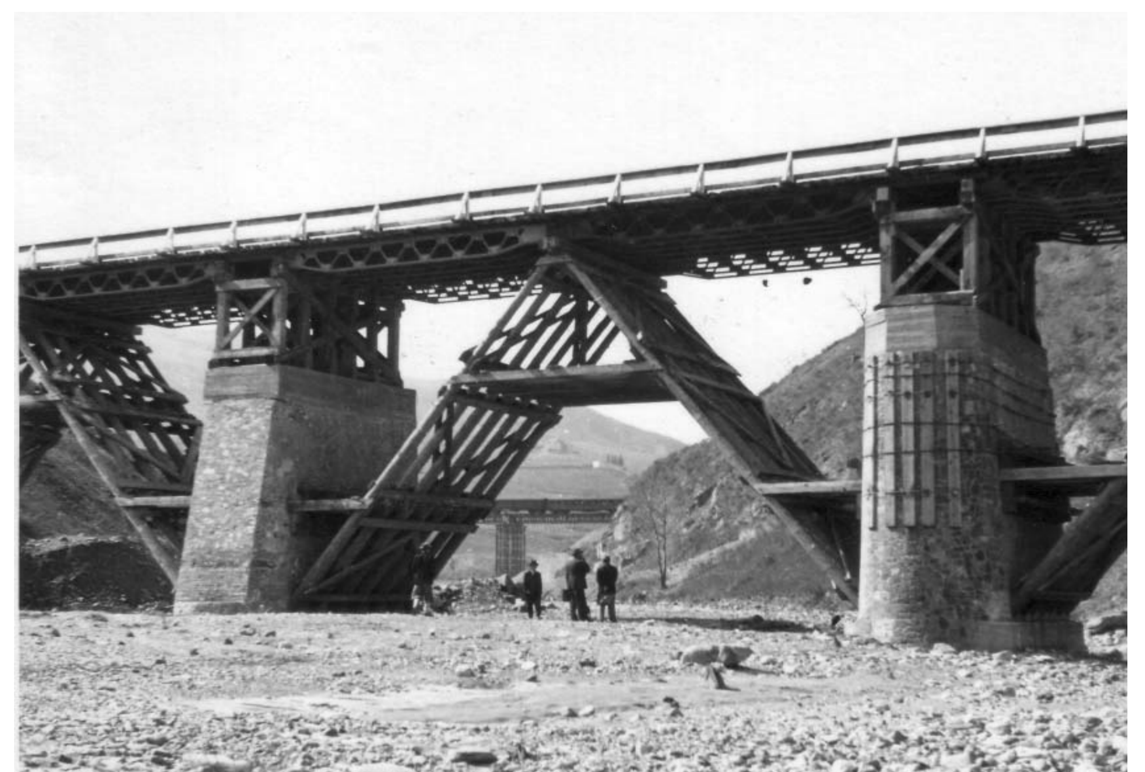
Una delle campate del ponte provvisorio sul Brasimone con le imponenti strutture lignee (ASPB)
