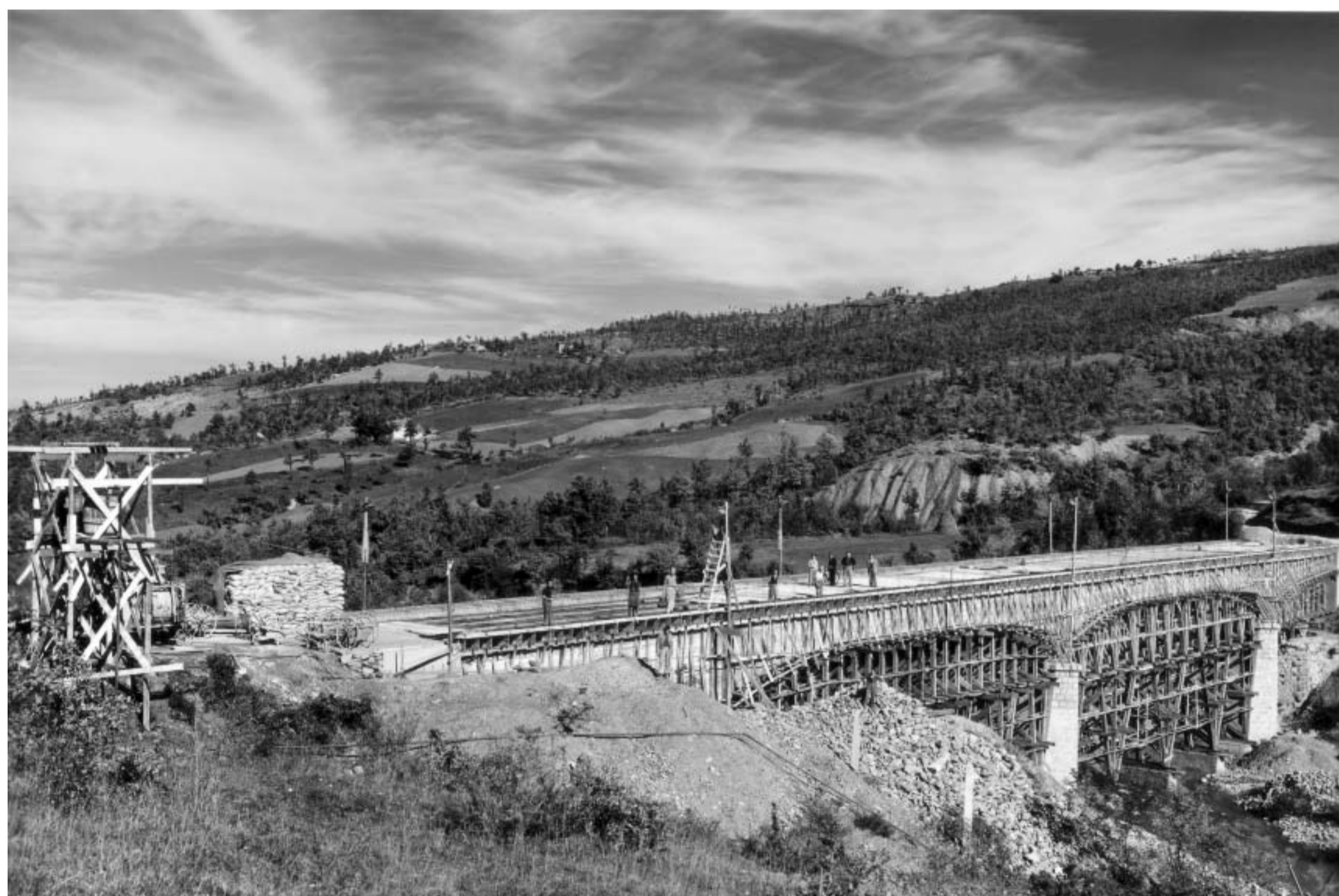
Il ponte sul torrente Dardagna ancora sorretto dalle armature lignee. Sulla destra s'intravedono i resti dell'antico ponte in muratura (Foto Studio A. Villani, Bologna, anno 1949-ARER)
