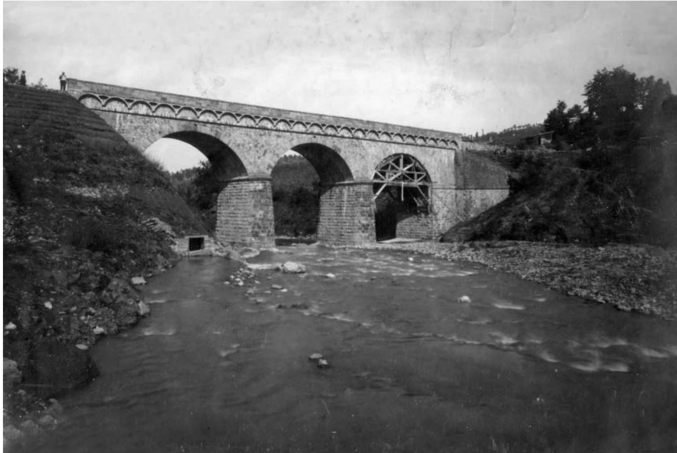
L'antico ponte sul torrente Dardagna, posto sull'allora strada Porretta-Fanano, in confine tra le province di Bologna e Modena (ASPB)
