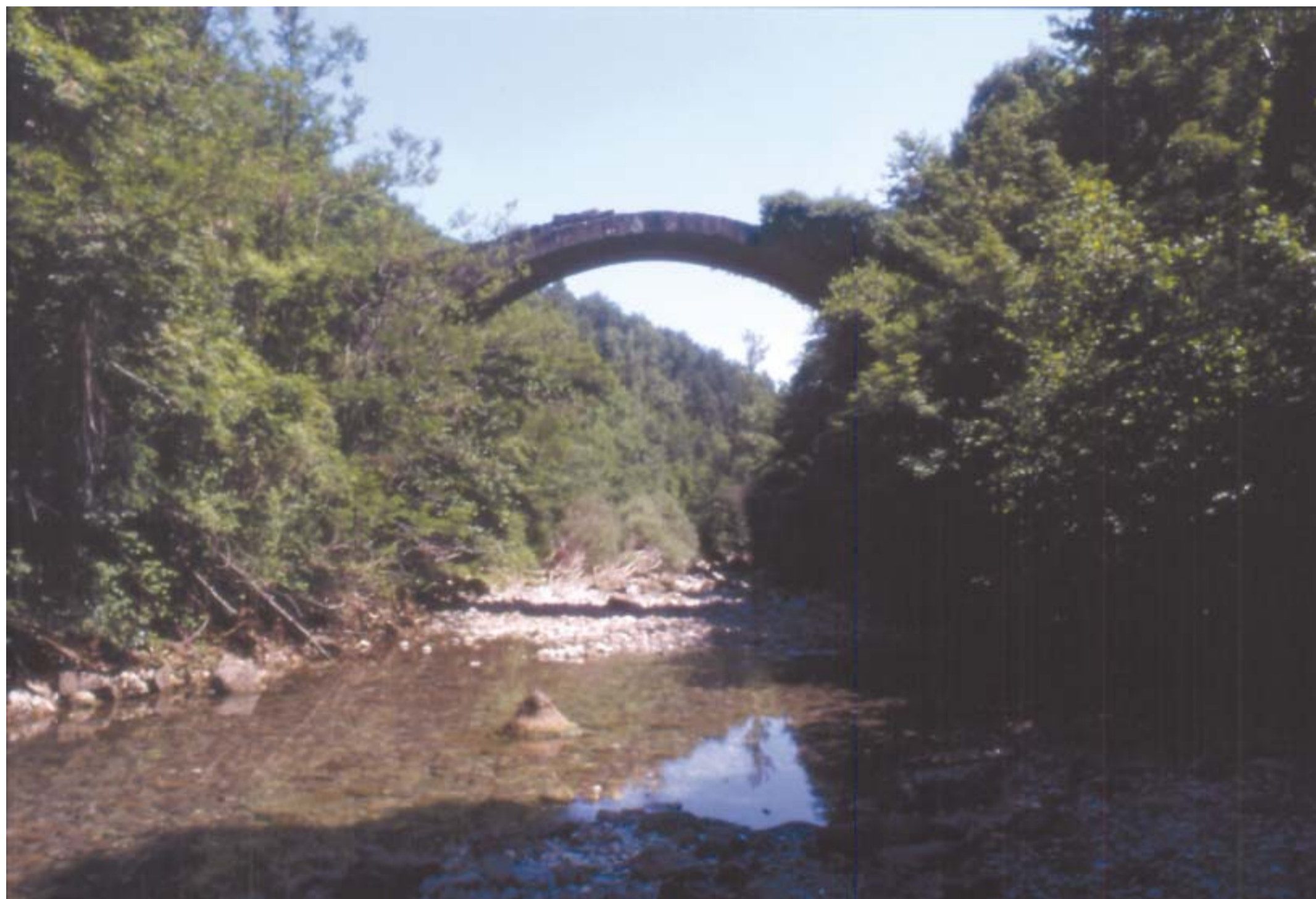
Il ponte di Castrola oggi abbandonato e prossimo al crollo (Foto S.Venturi-IBC)
