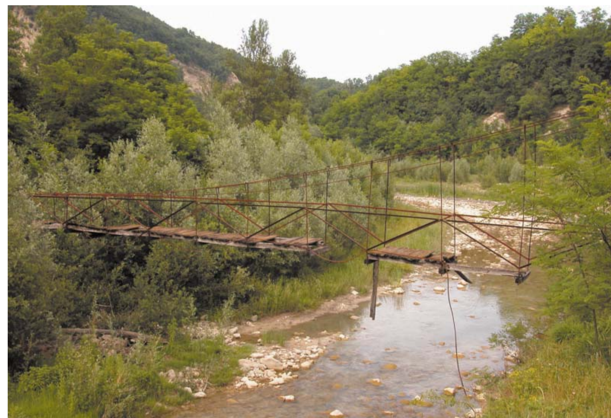
Passerella sospesa, semidistrutta sul Savena, presso Scascoli di Loiano (foto R.Vlahov-IBC)
